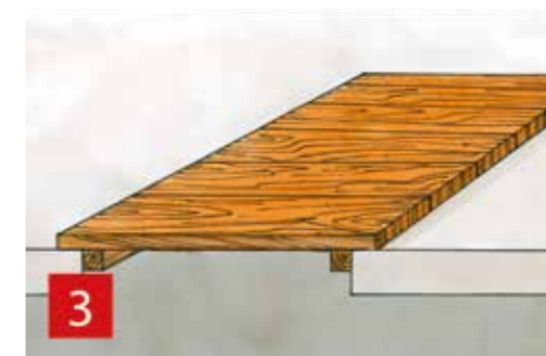
3 Bodenöffnungen durchtrittsicher abdecken und Abdeckungen gegen Verschieben sichern.
